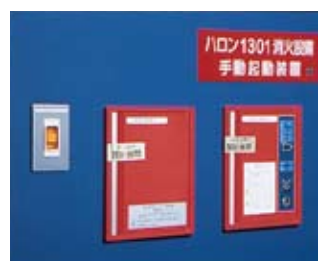
ハロン消火設備
