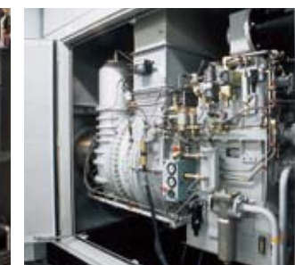
自家発電設備
