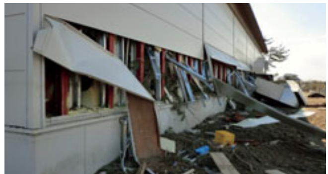
被災した設備 上段左) auショップ 上段右) au釜石両国基地局 下段) JIH仙台局舎
