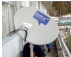
衛星通信を介したauフェムトセル用アンテナ(宮城県石巻市)
